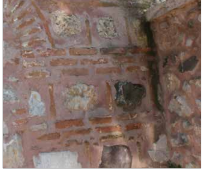
Photo 16 - Göktaşlı Mosque, western façade, salt crystallization and microbiological formation. / Göktaşlı Cami, batı cephesi, tuz kristalleşmesi ve mikrobiyolojik oluşum.
