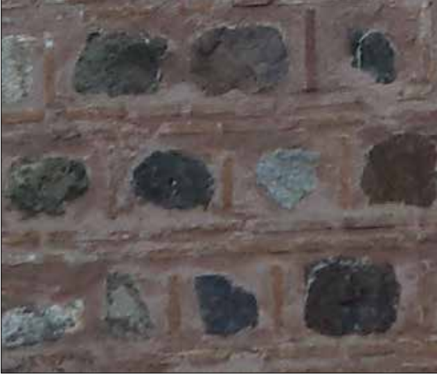
Photo 15 - Göktaşlı Mosque, western façade, excessive mortar usage. / Göktaşlı Cami, batı cephesi, aşırı harç kullanımı.
