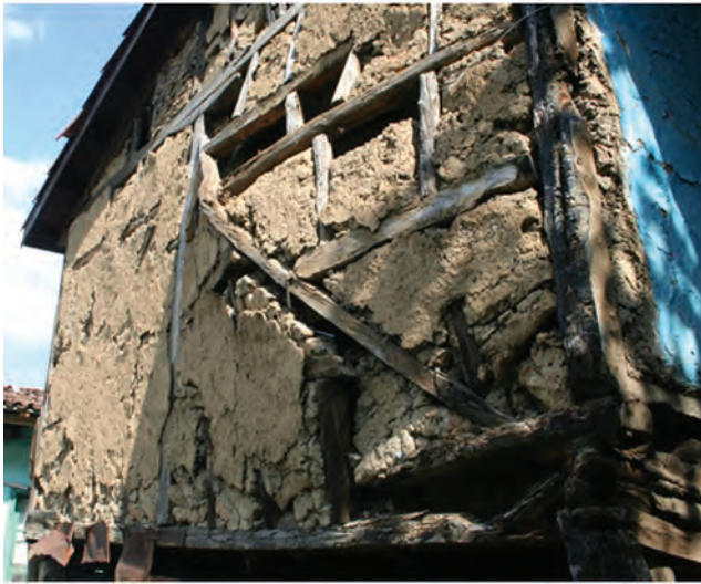
Fotoğraf 9 - Dış duvarda oluşan deformasyon / The deformation of the wall (Aksoy, 2015)
