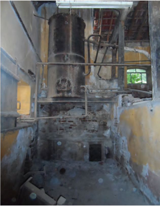
Fotoğraf 13 - Z03 Sıcak su tankı / Z03 Hot water tank
