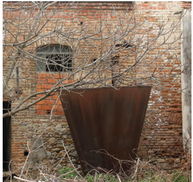
Fotoğraf 15 - Buhar kazanına su gönderen soğuk su tankı / Cold water tank for steam boiler
