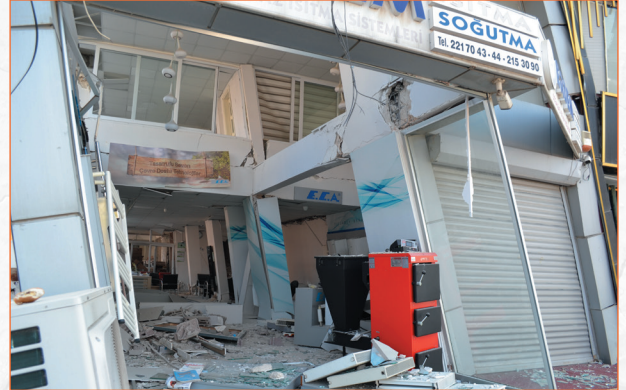
Fotoğraf 8. Yumuşak kat oluşumu
