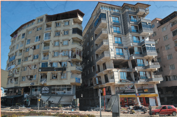
Fotoğraf 10. Yumuşak kat deformasyonları ve hasarı
