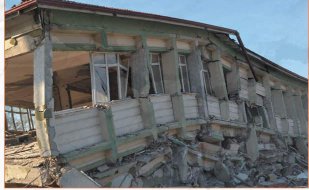
Fotoğraf 14. Kısa kolon oluşumu ve hasarı
